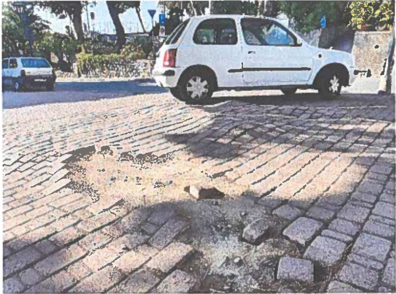
Figura 7 - evidenti sollevamenti della pavimentazione
