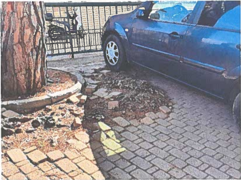
Figura 8 - evidenti sollevamenti con radici affioranti che rendono inidonea la superficie alla sosta dei veicoli
