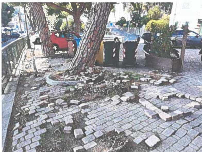
Figura 6 - area di fatto resa inaccessibile da barriere improvvisate per forte dissesto
